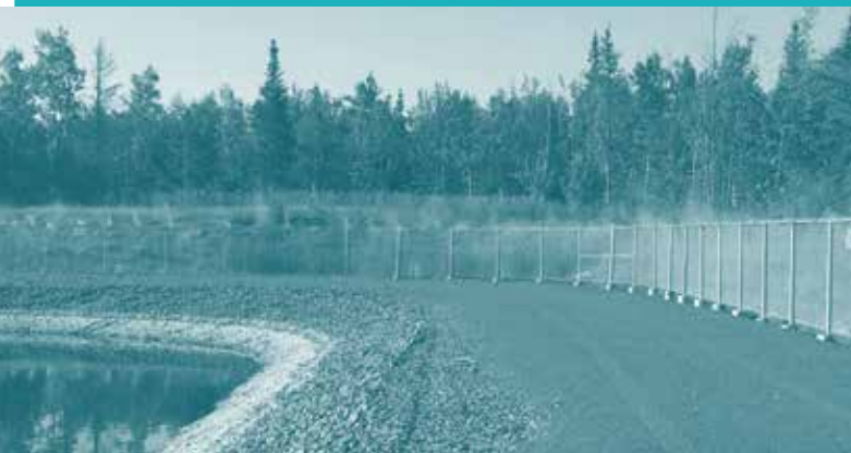
Installation de neutralisants d'odeurs autour du bassin.
